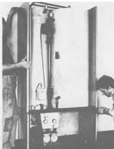
Fig. 14. Kabinettes sideplader påsættes. (Bemærk nøglehulsudsparring i bagkant med låsekast). Befæstiges med skrue på forkant i sokkel.
